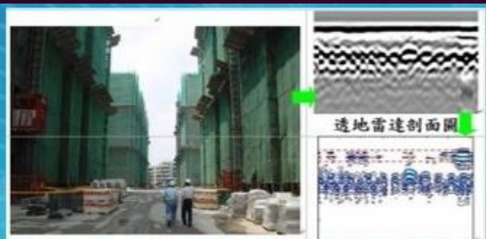
台中建築房屋峰窩/裂縫檢測
