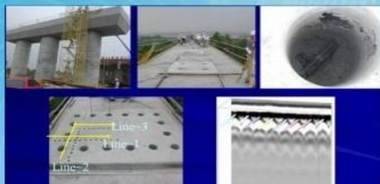
新竹快速道路支承墊峰窩檢測
