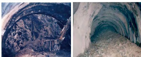
隧道開挖破碎帶抽坍
