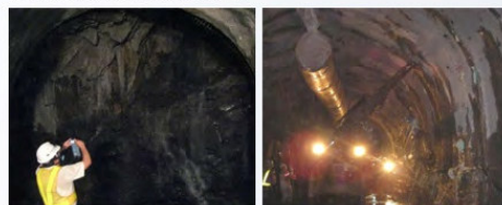
隧道開挖溫泉突湧封堵
